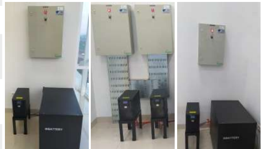
UMPP PEKAJANGAN PEKALONGAN
